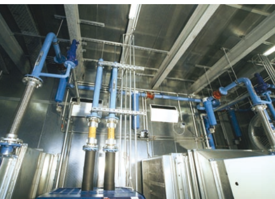
Die zwei drehzahlgeregelten Anlagen sind in das Ringleitungsnetz eingebunden
