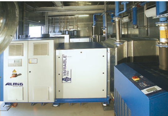
Blick in den Kompressorenraum
